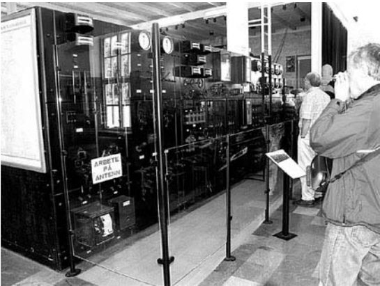
Den imponerande kontrollpanelen.
