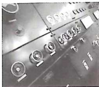
Del av kontrollpanelen.
