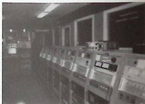
Del av kontrollrummet
